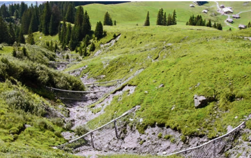
Ryc. 6. Układ barier elastycznych zainstalowanych w korycie potoku, w którym okresowo pojawiają się spływy gruzowe
