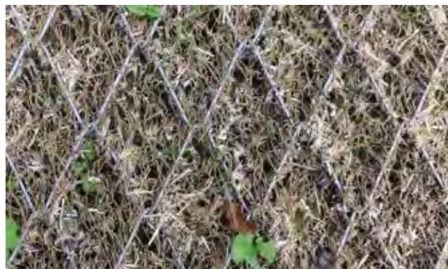
Abb. 7: Sicherungsmassnahme nach dem aufbringen einer Hydrosaat. Die teilweise langen Strohfasern konnten die Krallmatte nicht durchdringen.
