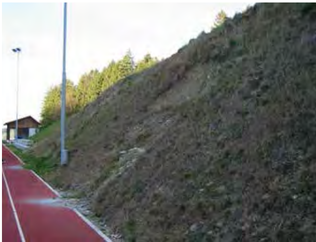
Abb. 1: Sporadische Rutschungen bei einem Böschungsanschnitt im Bereich einer Sportanlage.
