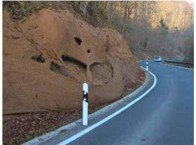
Abb. 2: Böschung mit einem Geotextil aus Naturfasern mit einer Neigung von ca. 50° als Erosionsschutz zur Begrünung ohne Vernagelung. Aufgrund der geringen Zugfestigkeit ist das Geotextil abgerissen.
