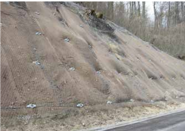
Abb. 14: Böschung ein Jahr nach der Installation im April 2006. Der Stabilisierungseffekt jedoch auch Verschiebungen der Erosionsschutzmatte, ist durch Ausbauchungen erkennbar.
