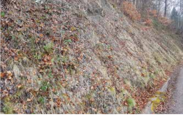
Abb. 13: Straff gespanntes TECCO® Geflecht. Im unteren Bereich und lokale Fehlstellen im oberen Drittel der Böschung (März 2018).
