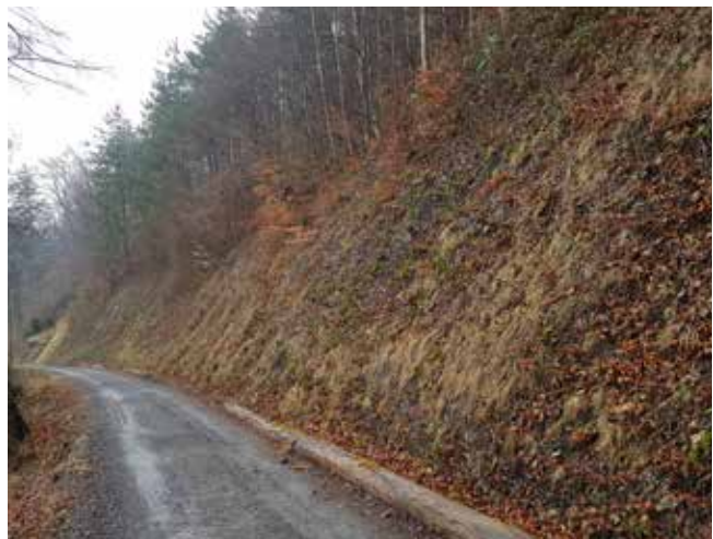
Abb. 12: Böschung nach 13 Jahren mit üppiger Vegetation (März 2018).
