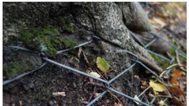
Abb. 9: In das TECCO® Geflecht eingewachsener Baum. Ohne Verformungen und ohne das Abheben des Geflechtes (September 2017).
