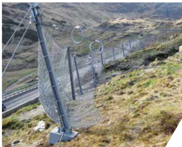
Barriere contro colate detritiche
