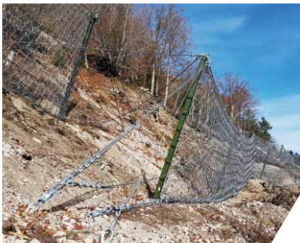
Barreras contra la caída de rocas
