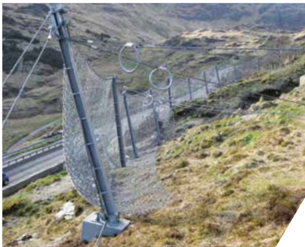
Barreras de protección contra deslizamientos
