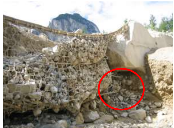
Abb. 4: Freigespülte Verankerung einer Murgang-Sperre. Verankerung teilweise im Lockergestein und in bestehender Betonsperre.
