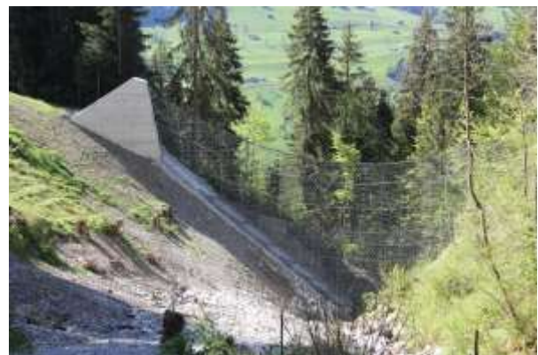
Abb. 9: Spezialbauwerk Murgangrückhalt Hüpach (Schweiz) mit 40 m Spannweite und 10 m Netzhöhe.
