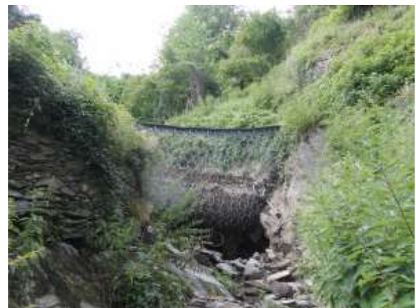
Abb. 7: Teilverfülltes Murgang-Netz oberhalb der DB Strecke im Mittelrheintal
