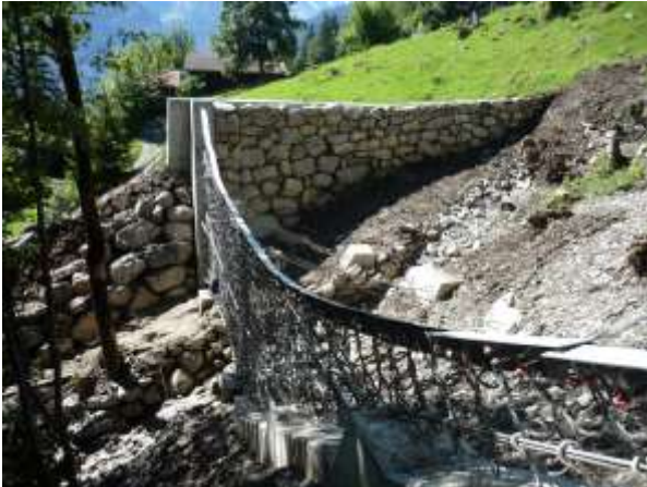
Abb. 8: Murgangschutznetz oberhalb einer Siedlung. Die Anprallseite des Murgangs wurde hier mit einer Blockmauer stabilisiert.
