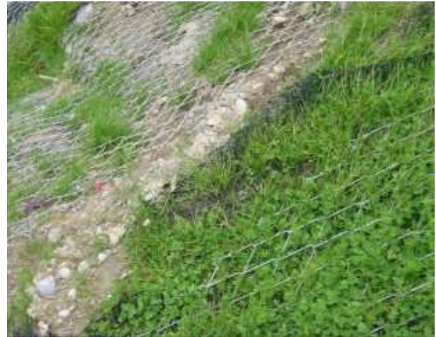
Abbildung 9: Versuchsfläche ca. 10 Wochen nach der Nassansaat und nach einem Starkniederschlag. Links die Referenzfläche ohne Erosionsschutzmatte mit weniger als 10 % Begrünungserfolg. Rechts mit einer Krallmatte mit einem Begrünungserfolg von mehr als 90 %.
