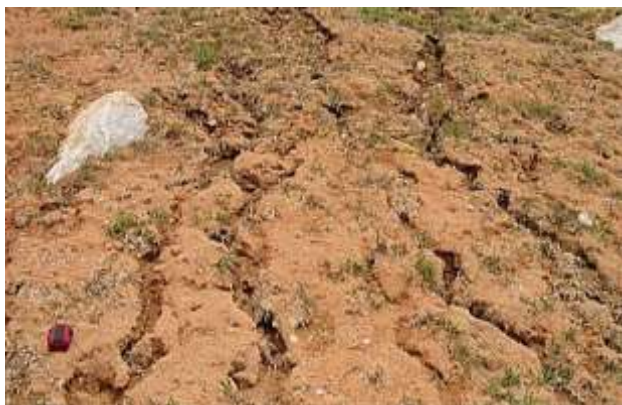
Abbildung 3: Erosionsrinnen durch den Fliess-Effekt des abströmenden Wassers, wodurch Boden abgetragen und der Pflanzenwuchs verringert bzw. verhindert wird.
