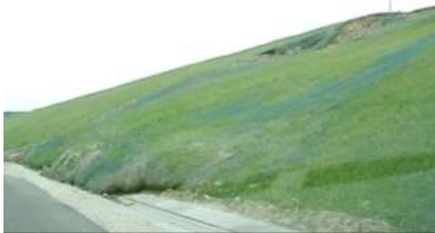
Abbildung 2: Rutschung in einer Böschung mit ca. 25° Neigung, gesichert mit einem Geotextil / Erosionsschutzmatte zur Begrünung ohne Vernagelung.
