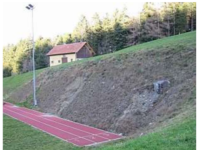
Abbildung 1: Sporadische Rutschungen bei einem Böschungsanschnitt im Bereich einer Sportanlage.
