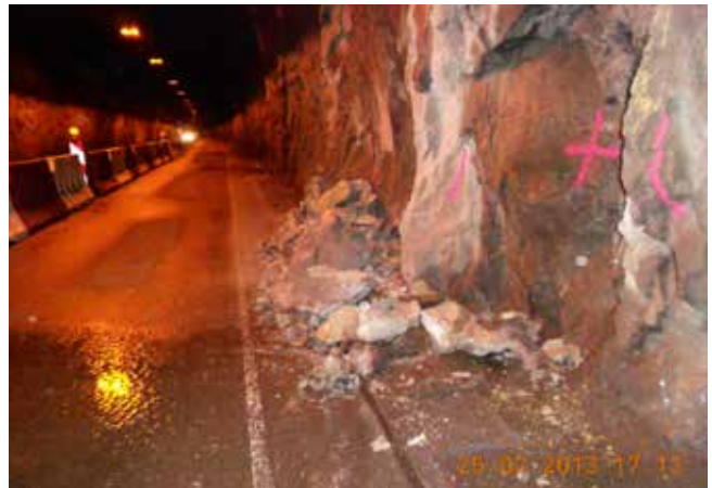
Bild 2: Zustand des bestehenden Tunnels vor den Sicherungsarbeiten
