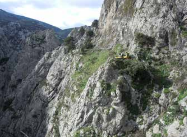
Bild 6: Installationsplatz für Kompressor
