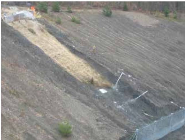
Abb. 2: Testanlage Veltheim, Schweiz, für Hangmuren zur Untersuchung des Fließverhaltens und der Schutzverbauung.
