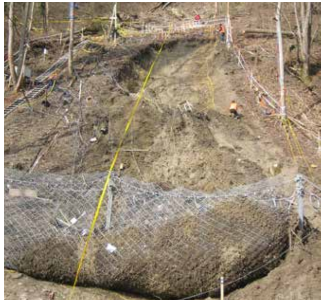
Abb. 1: Künstlich ausgelöste oberflächige Rutschung mit einer Anrisstiefe von ca. 2 m ausgelöst durch Infiltration von Wasser (Eidgenössische Forschungsanstalt WSL) mit Hangmurenetz am Böschungsfuss.
