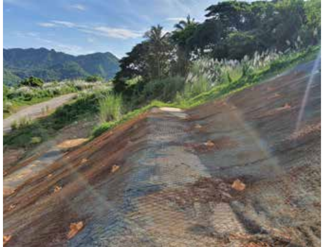
Abb. 11: Korrosionsschaden kurze Zeit nach Fertigstellung der Maßnahme, weshalb Untersuchungen bezüglich der Korrosivität des Bodens und Wassers gemacht wurden.
