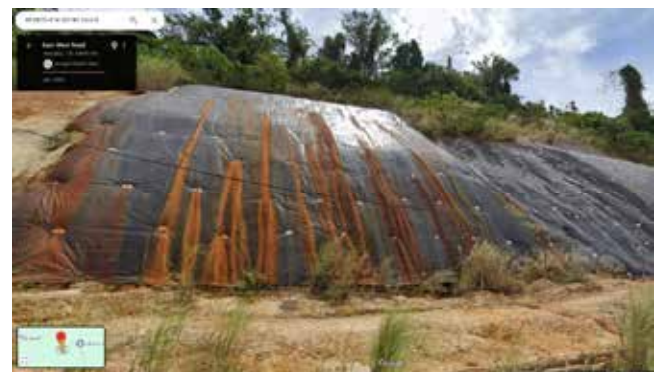
Abb. 17: Eisenoxidausfällungen an den Wasseraustritten in der TECCO STAINLESS Installation. Foto google street view Jan. 2025.
