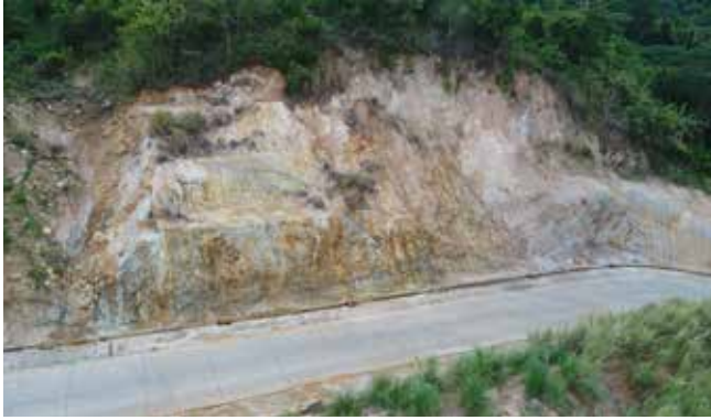
Abb. 9: Kritische Böschung vor dem Zurücksetzen und Reprofilierung.
