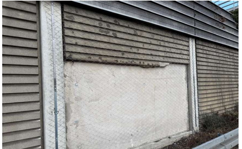
Installation an der A2 bei Braunschweig. Zusätzliche Details finden Sie in den Referenzen zum Thema Einschlagschutz auf: www.geobruigg.com/A2
