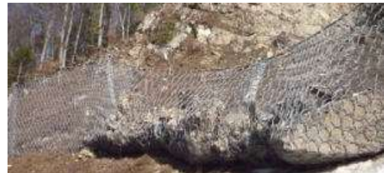
Abbildung 2: Versagen einer Stütze durch Steinerschlag. Das Schutzziel wurde trotzdem erreicht.
