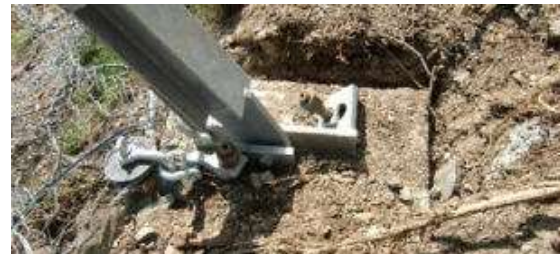
Abbildung 3: Versagen eines Betonfundamentes. Das Schutzziel wurde trotzdem erreicht.
