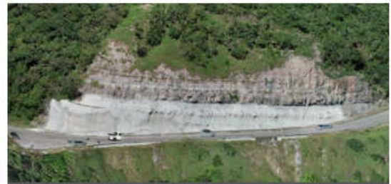
Figura 8: tratamento com sistema TECCO na parte superior e Concreto projetado na parte inferior do talude.
