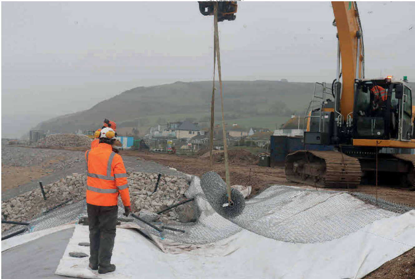
Zur Installation wird ein Edelstahlnetz auf einer Geotextil-Unterlage ausgerollt. Darauf kommt eine Lage Gestein, das in einer flachen, meist mehrere Meter langen und breiten „Zelle“ mithilfe des Netzes abschnittsweise fixiert wird. Foto: Geobrug
