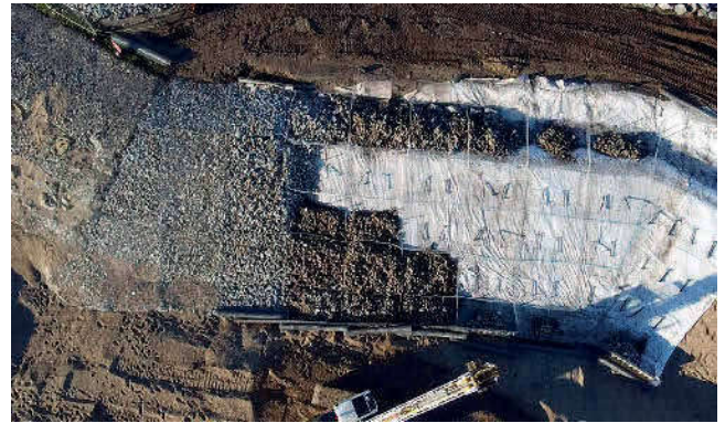
Das fertig verbaute System
