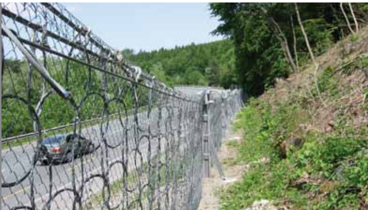
Abb. 1: Moderner Steinschlagschutzzaun entlang einer Strasse
