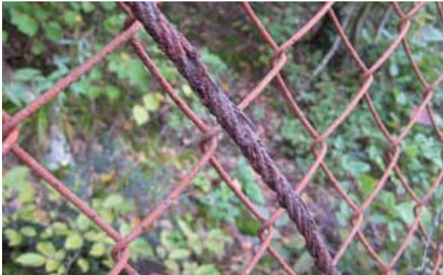
Abb. 2: Konstruktion zum Schutz vor Steinschlag aus den 1970er Jahren. Die Beschichtung zum Schutz vor Korrosion ist vollständig abgetragen und der tragende Querschnitt ist massiv reduziert.
