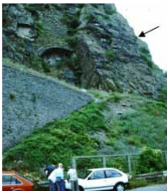
Abb. 2: Absturzgefährdeter Felskörper (Pfeil) und links anschließend mit Ankern gesicherte Felskörper (Pfeil). Mitte links die Außenmauer des Tunnelvorbau.
