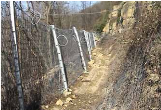
Abb. 1b: Freigelegter Auffangraum mit Fangzaun (System Geobrugg, Aufnahmefähigkeit 750 kJ) vor der alten Mauer, die hinter dem Fangzaun noch zu erkennen ist, und Drahtnetzverhängung als Arbeitsschutz.
