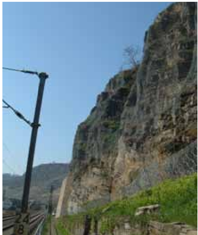
Abb. 5: An den Felshang angepasste TECCO-Verhängung, Fangzaun mit Ringnetzen und neu errichteter Futtermauer im Hintergrund (umgekehrte Blickrichtung zu Abb. 4).
