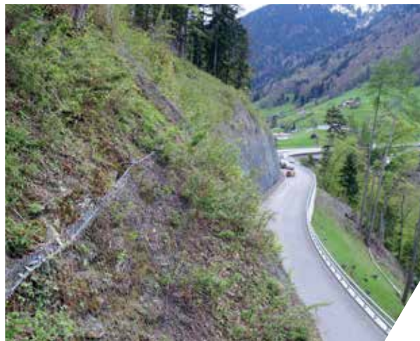
Grillage de protection contre les chutes de pierres (Ancrage du câble de bordure)
