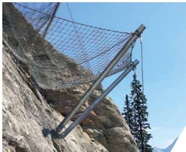
Protección contra aludes con redes de cables espiroidales
