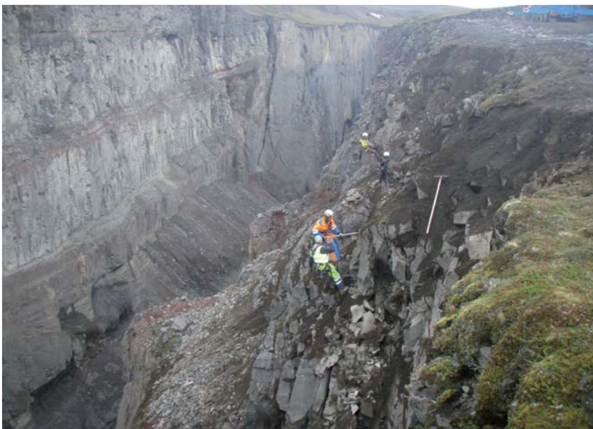
Um die Sicherheit für die Arbeiter beim Bau des Rückhaltedamms zu erhöhen, wurde zuerst eine Felsräumung durchgeführt.
