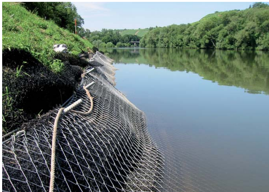
Malla metálica TECCO® sumergida bajo la superficie del agua
