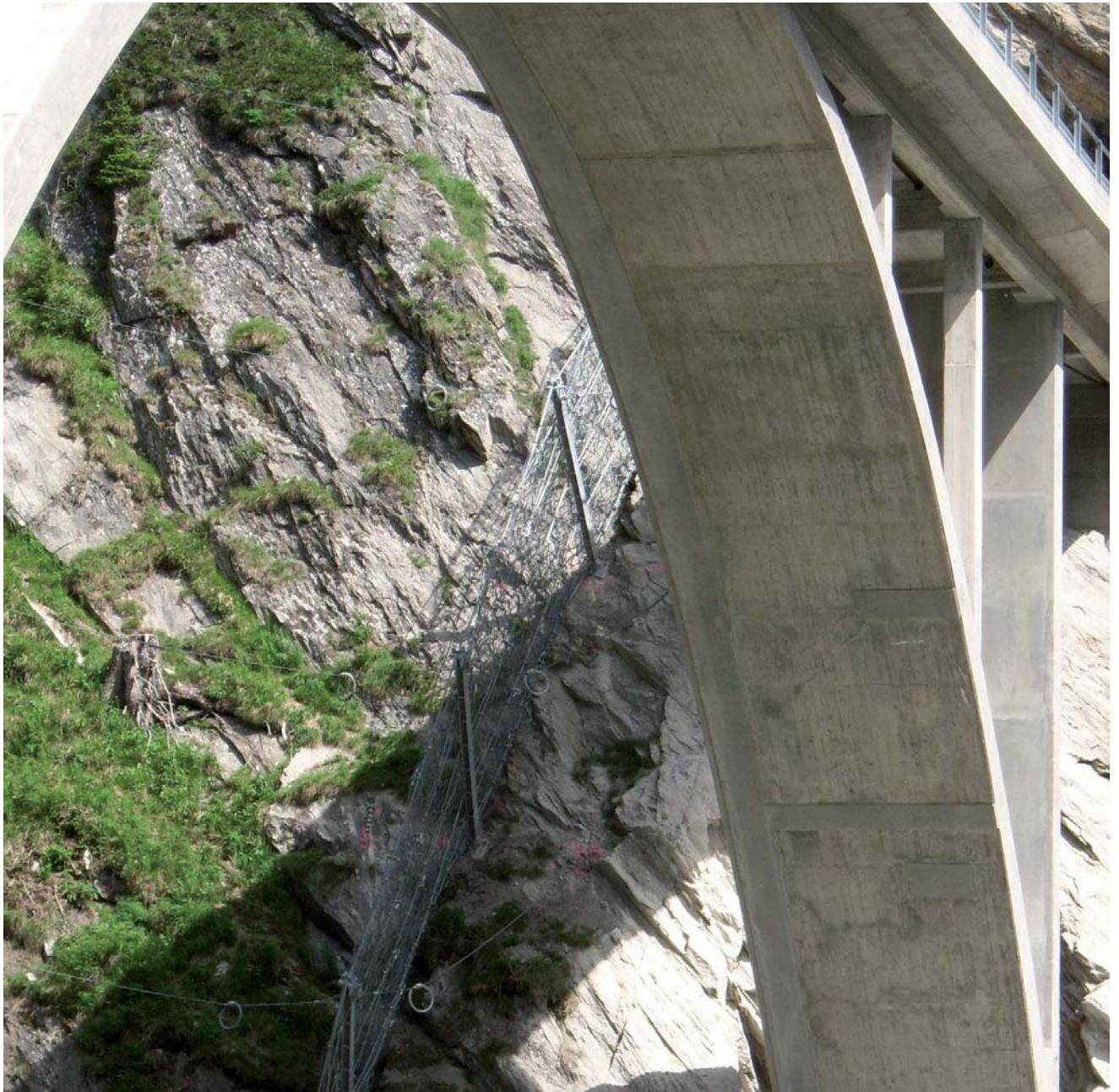
Rockfall deflector protection Avers-Reno di Lei / Switzerland
